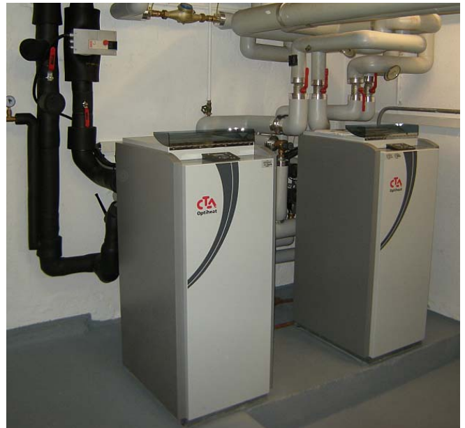
Neue Erdsonden-Wärmepumpenanlage mit 2 Wärmepumpen von CTA in Master - Slave - Schaltung
