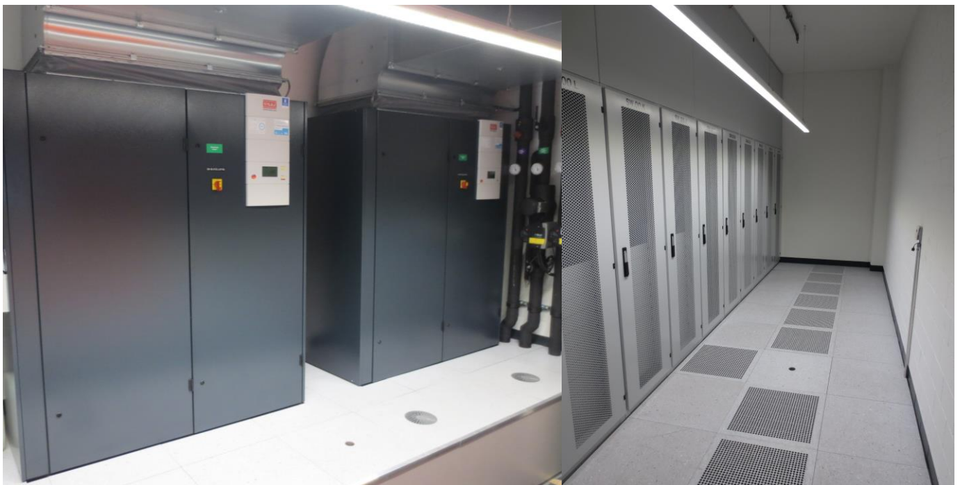
2 redundante Klimaschränke Stulz ALD 321 mit Freecooling
