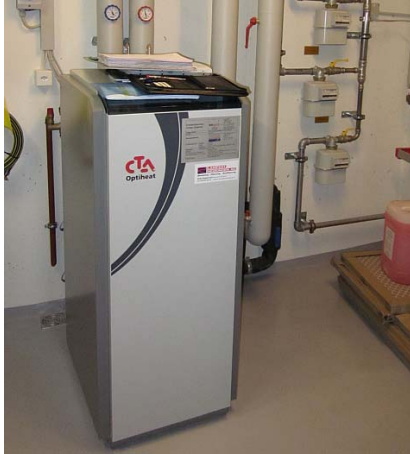
Für die Heizung reicht 1 Wärmepumpe mit 15 kW Heizleistung mit einer 310m tiefen Erdwärmesonde
