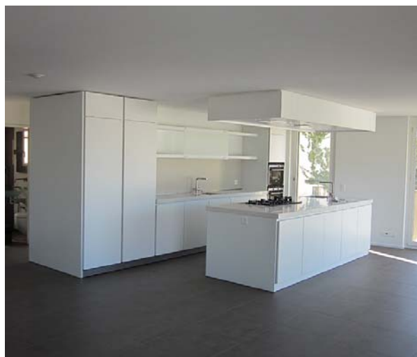
Eingelegte Luftverteilung der Wohnungslüftung mit Tellerventilen als Luftdurchlässe an der Zimmerdecke
