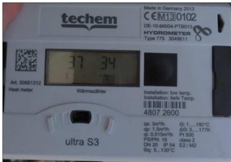
Abb. 1.9: Wärmezähler der FBH mir Vor- und Rücklauftemperatur der FBH.
