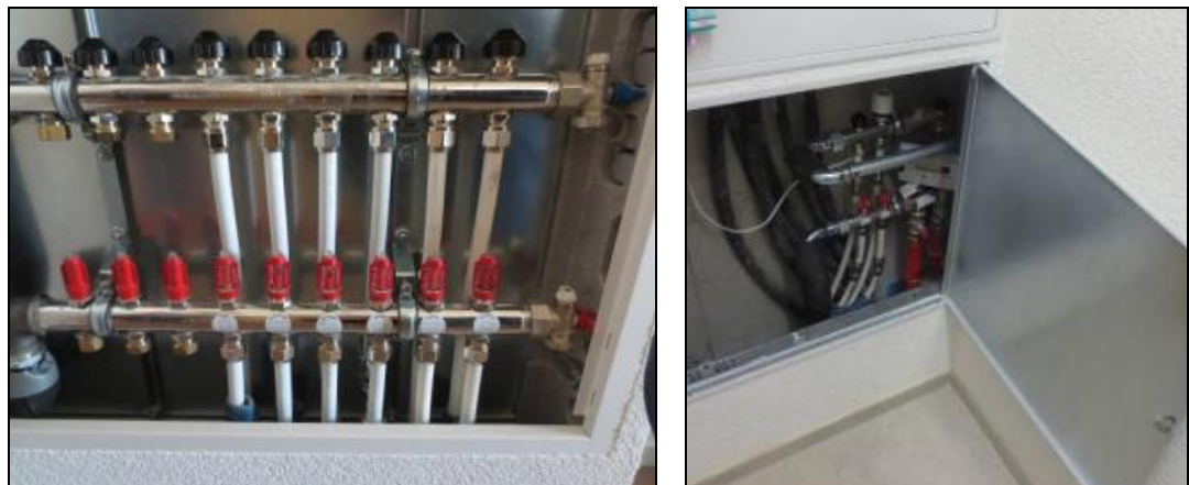
Abb. 1.4: Links der neu installierte Heizkreisverteiler im Gang, rechts der alte Heizkreisverteiler im Redit.
