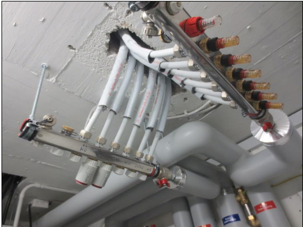
Abb. 4.3: FBH Verteiler für EG befindet sich an der Decke des UG.
