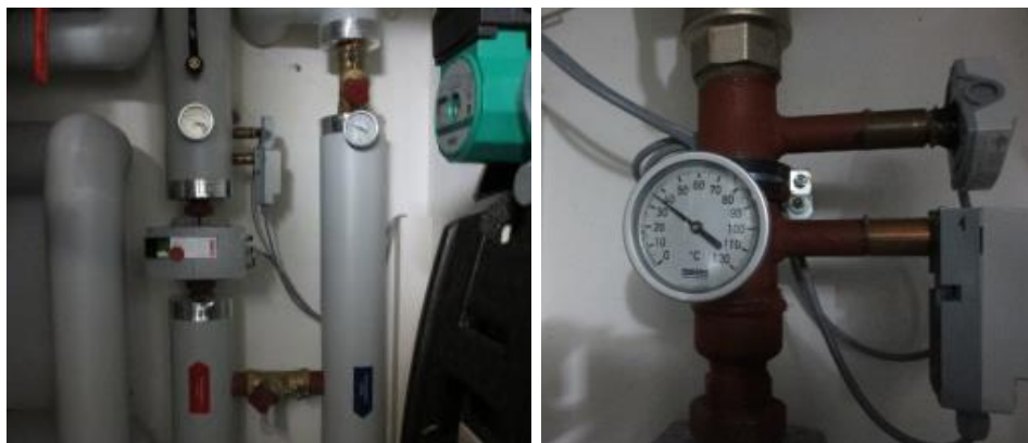
Abb. 1.26: links: Vor- und Rücklauf der FBH, rechts: Temperaturmessung des Vorlaufs.
