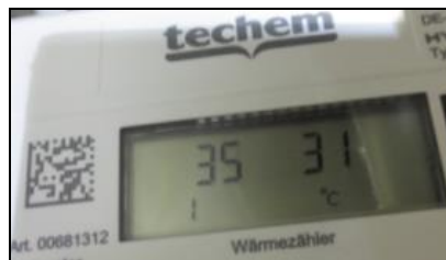
Abb. 1.13: Wärmehähler der FBH mit Vor- und Rücklauftemperatur der FBH.
