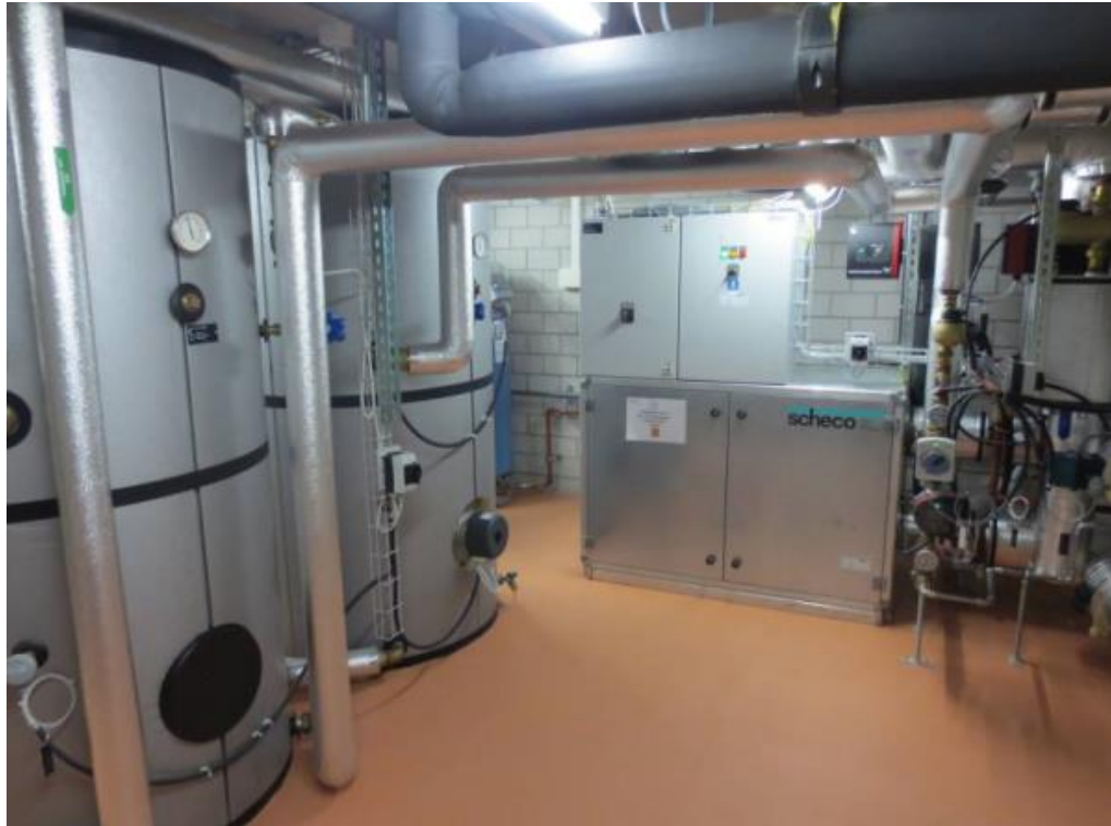
Abb. 2.27: Links, die beiden Warmwasserspeicher und rechts die Sole-Wasser-Wärmepumpe der Firma Scheco.
