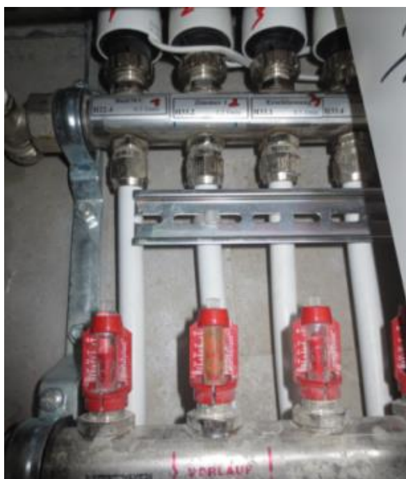
Abb. 3.12: FBH Verteiler mit geöffneten Thermostatventilen
