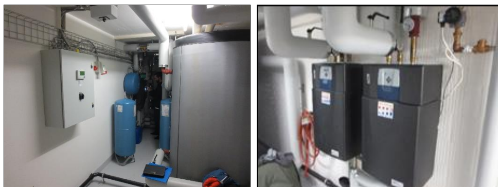
Abb. 1.27: links: Übersicht des Heizungsraums mit Speicher, rechts: Frischwasserstationen für die Brauchwarmwassererwärmung.
