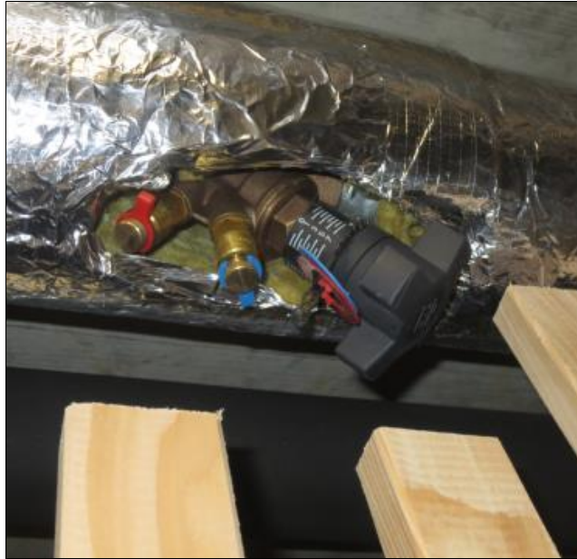
Abb. 3.27: Strangregulierungsventil der Unterstation von Haus H.
