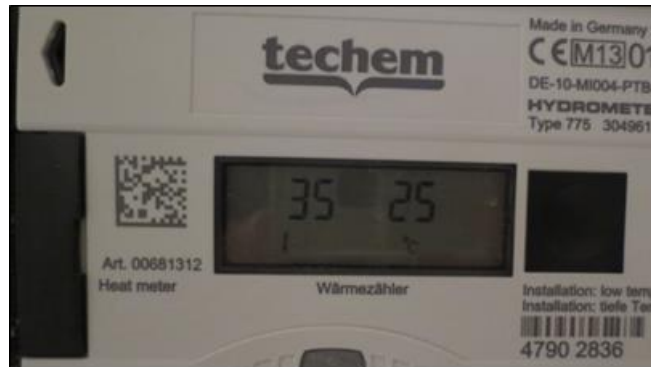
Abb. 1.20: Wärmehähler der FBH mit Vor- und Rücklauftemperatur der FBH.
