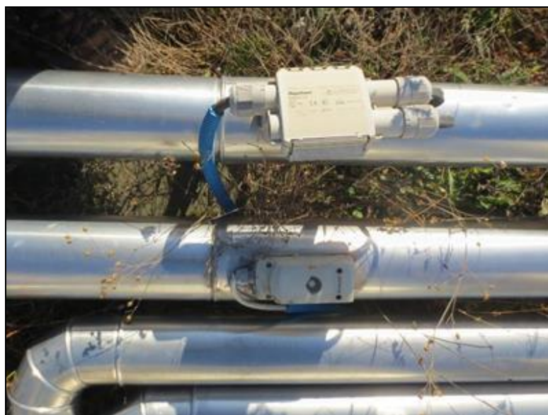
Abb. 1.25: Anschluss des Heizbands auf dem Vorlauf der Speicher, Regelgerät auf dem Dach.
