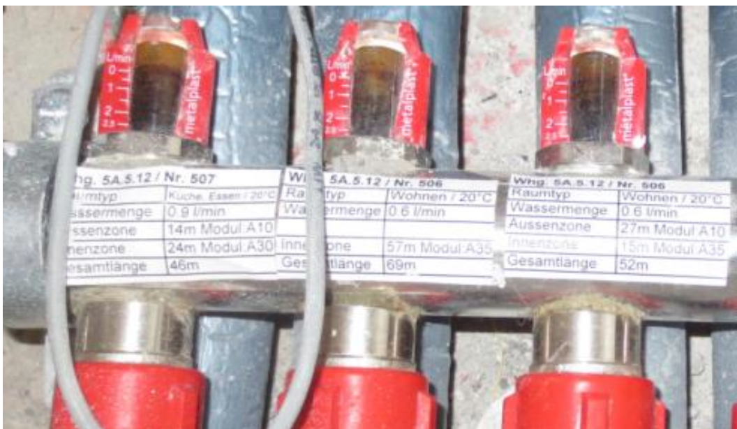
Abb. 7.4: Wassermengen berechnet und auf Verteiler beschriftet, aber nicht eingestellt
