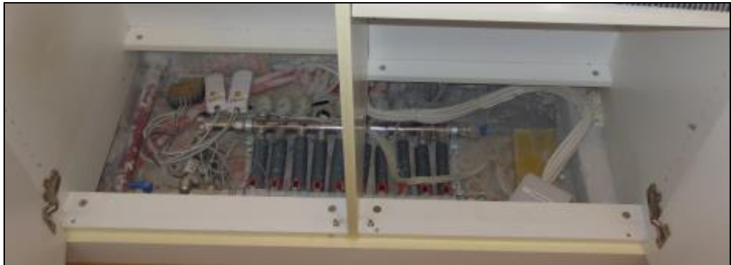
Abb. 7.1: FBH Verteiler unter Einbauschränk. 3 von 10 Heizkreisen sind ungeregelt.
