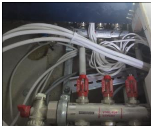
Abb. 3.24: FBH Verteiler mit geöffneten Thermostatventilen.
