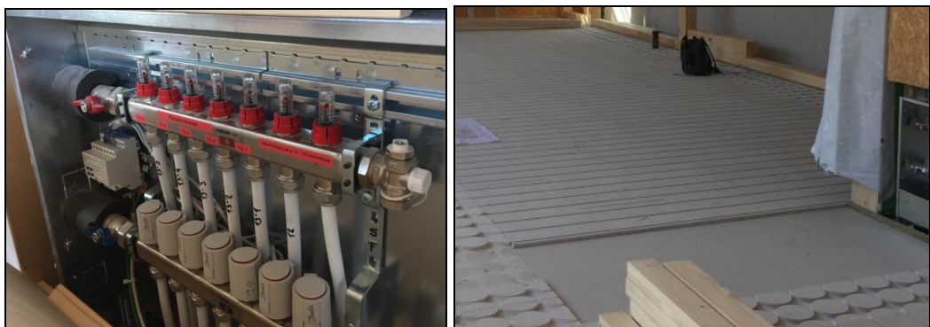
Abb. 8.2: Fussbodenheizungs-System Therm38 mit festem Verlegeabstand 17.5 cm Links: Verteiler mit KNX-Antrieben / Rechts: Verlegesystem von Fermacell
