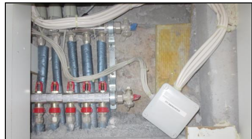
Abb. 7.3: FBH Verteiler unter Einbauschränk.
