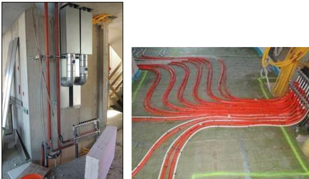
Abb. 2.25: links: Lüftungsanschluss pro Wohnung- Im Gleichen Schacht ist die Steigleitung für die FBH untergebracht, rechts: Abgänge aus dem Heizkreisverteiler.
