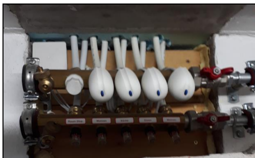
Abb. 9.2: FBH Verteiler unter Einbauschränk.
