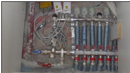
Abb. 7.2: FBH Verteiler unter Einbauschränk.
