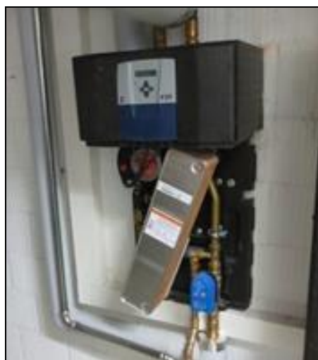
Abb. 1.28: Frischwasserstation mit Wärmetauscher und interner Pumpe.
