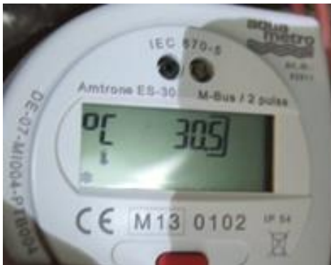
Abb. 2.4: Wärmehähler der FBH mit Vorlauftemperatur.
