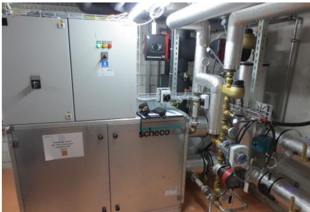
Abb. 2.28: Scheco Wärmepumpe mit Anschluss an der Erdwärmesonden, FBH und der Warmwasser-speicher.
