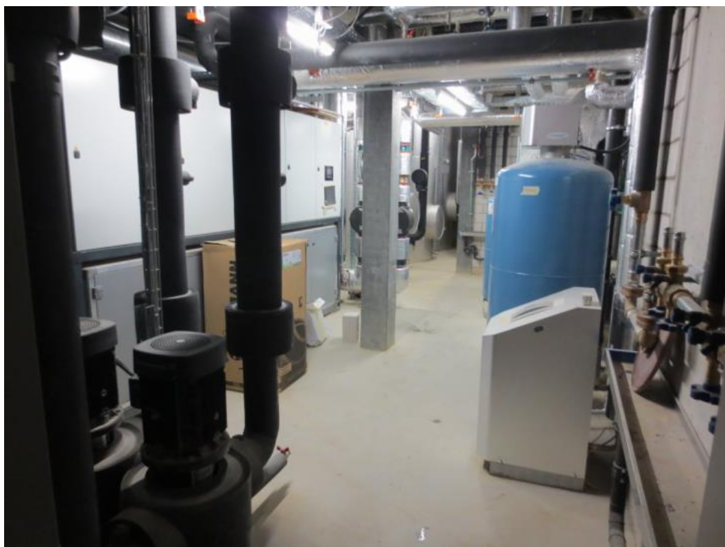
Abb. 3.26: Übersicht über den Heizungsraum mit Wärmepumpe, Speicher und Zirkulationspumpen der Erdwärmesonden.
